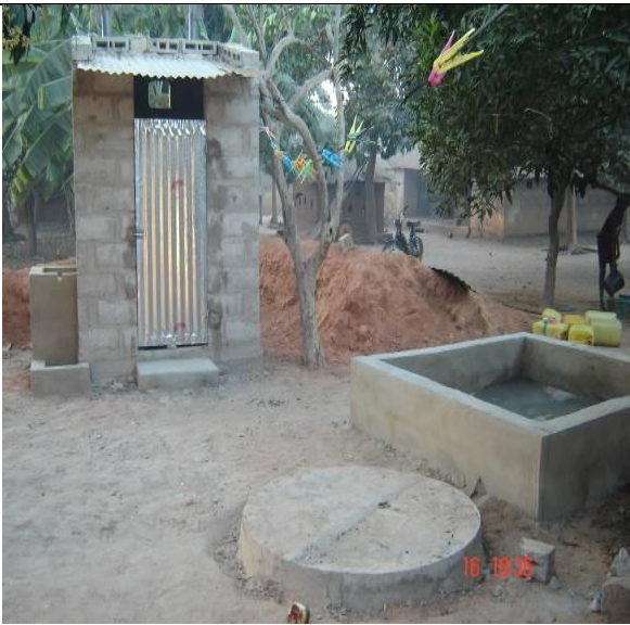
Ouvrages assainissement autonome- PDAZ (source PECHER/EDE)
