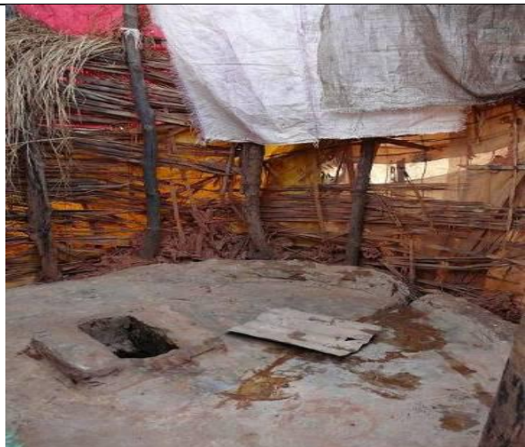
Déviation des eaux de douche (source PECHER/EDE)
